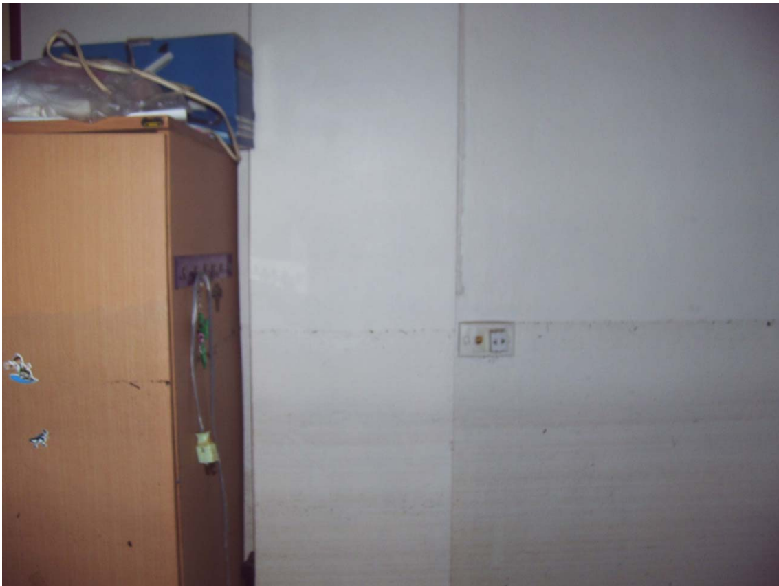
คราบระดับน้ำสูงสุด(ท่วมปลั๊กไฟ)
